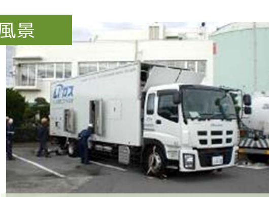
搭載された発電機から電力供給
