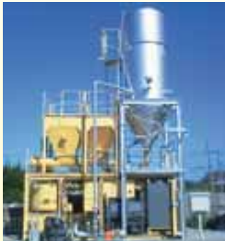
改質フライアッシュスラリー実機プラント
